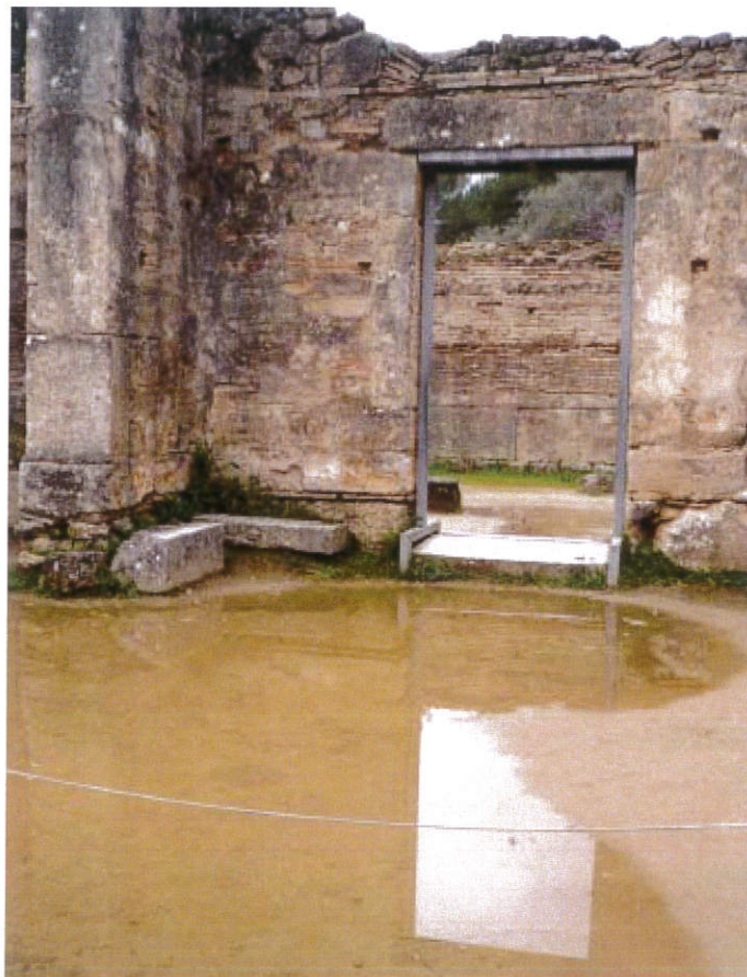
Εικόνα 9.1: Εργαστήριο Φειδία (Βασιλική). Συσσώρευση υδάτων εντός του μνημείου (DAI ATHEN). [Πηγή: Αποκατάσταση του εργαστηρίου του Φειδία (Βασιλικής) στην Ολυμπία. Αρχιτεκτονική Προμελέτη, Μπιλής, Θ. & Σωτηρόπουλος, Α. (2020), Γερμανικό Αρχαιολογικό Ινστιτούτο (DAI)].
